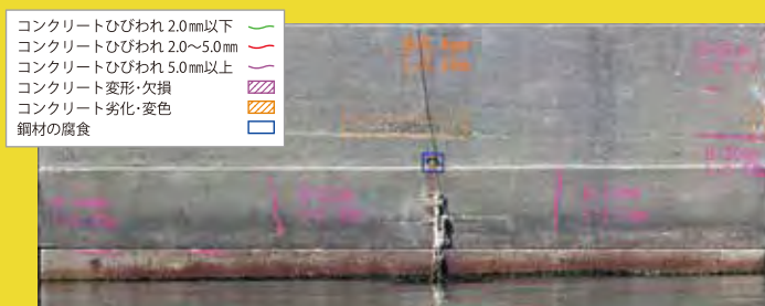
画像解析による劣化・損傷の抽出
