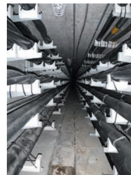
洞道内ケーブル
