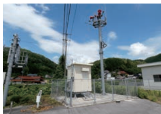
テレメータ・警報設備
