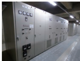
屋内受変電設備
