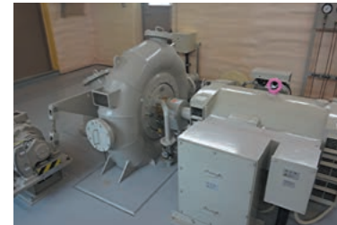
水車・発電機
