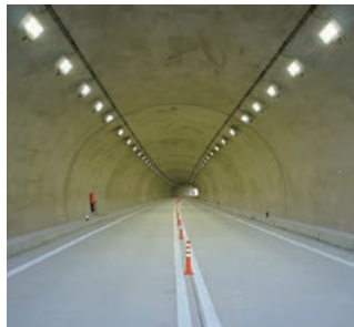
道路・トンネル照明設備
