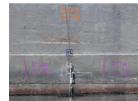
画像解析による劣化・損傷の抽出
