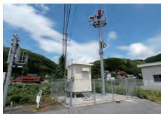
テレメータ・警報設備
