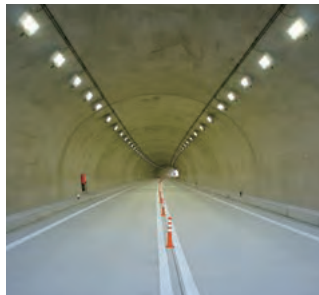
道路・トンネル照明設備
