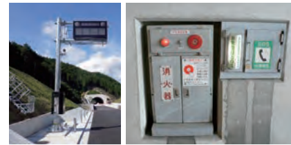
トンネル防災設備
