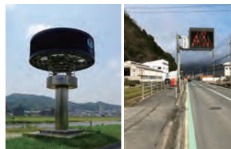
河川・道路情報表示設備
