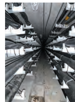
洞道内ケーブル
