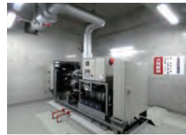
発動発電設備
