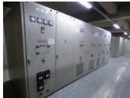
屋内受変電設備
