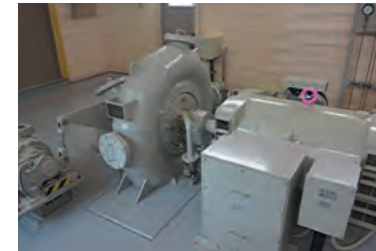
水車・発電機
