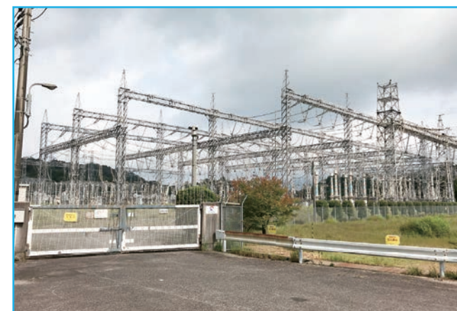
特別高圧変電所遠景
