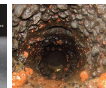
同左 腐食状況（内面目視）
