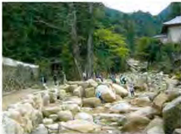
白糸川溪流保全工の完成状況
