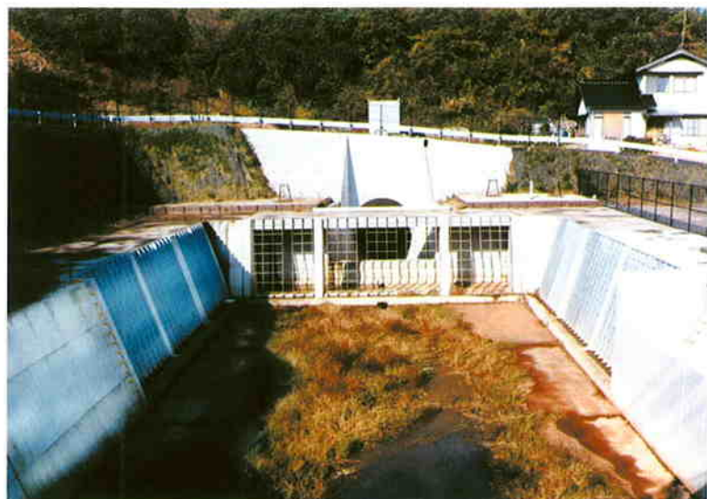
沈砂地・取水口
